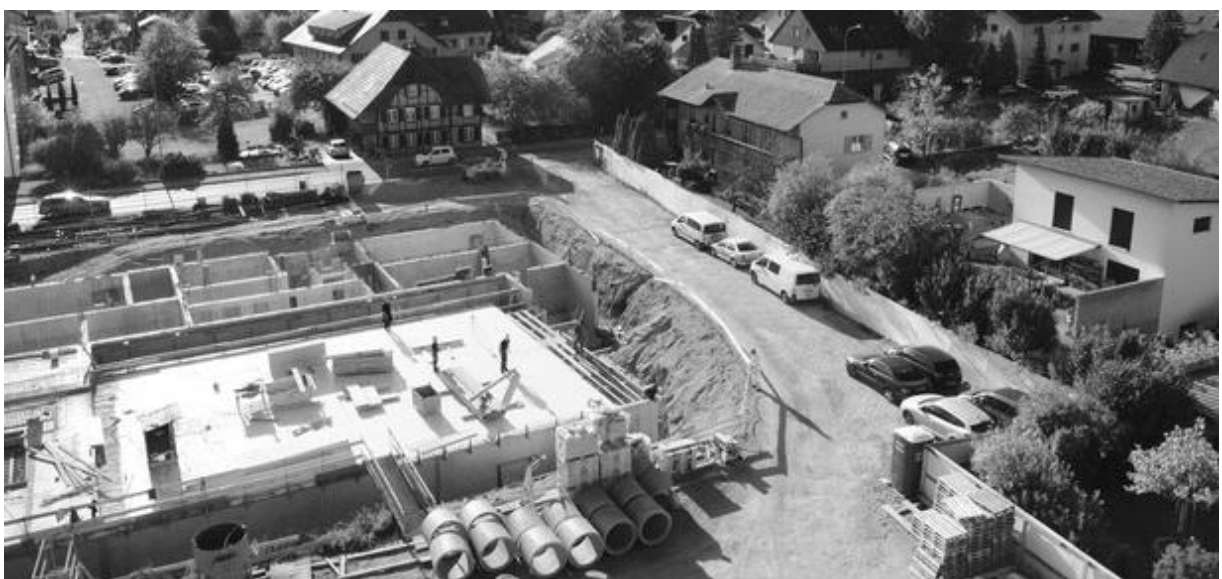
Stockfeld: An der Alten Bernstrasse werden 83 Wohnungen und eine Kita gebaut (Fotos: Uli Hess)
